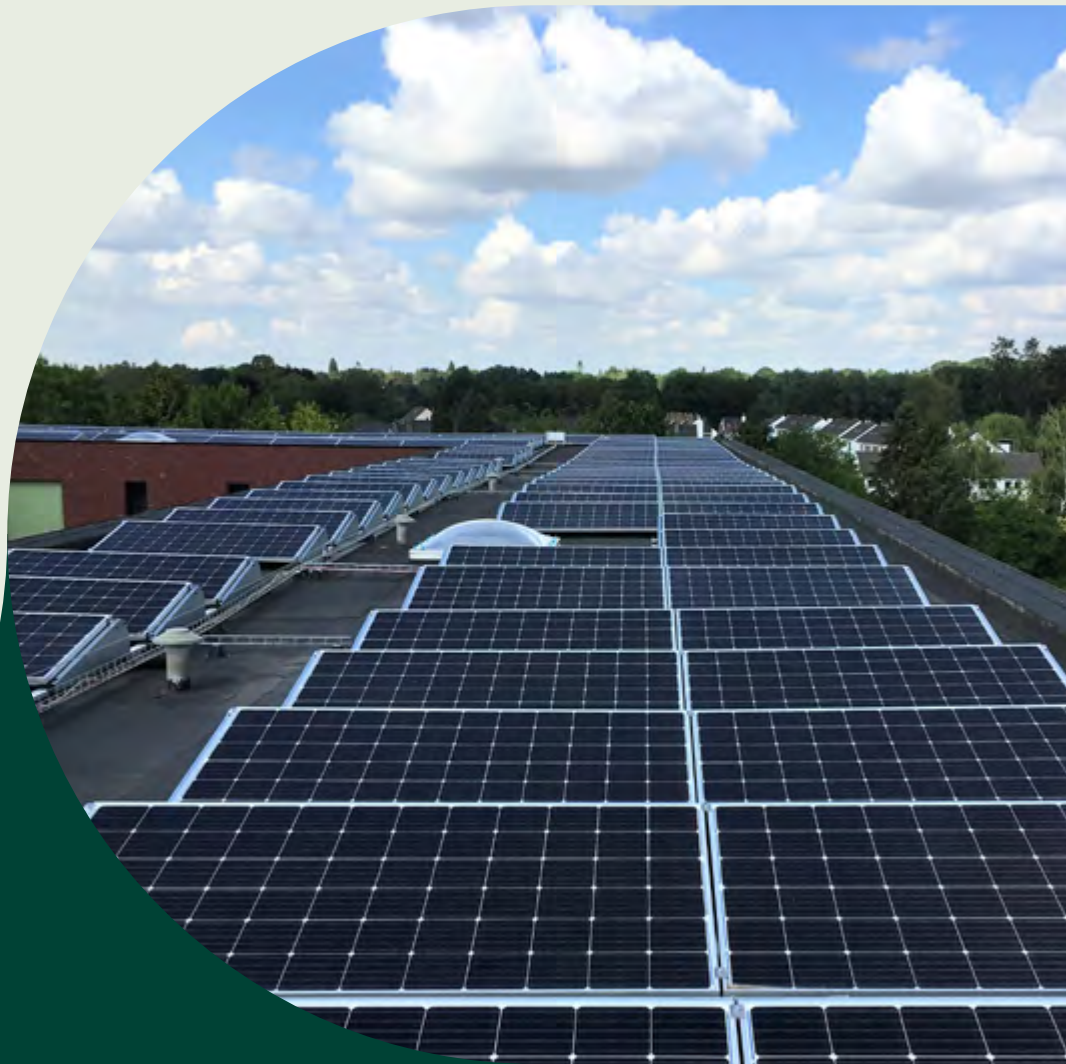
Zonnepanelen op woonzorgcentrum Zoniën in Tervuren.
