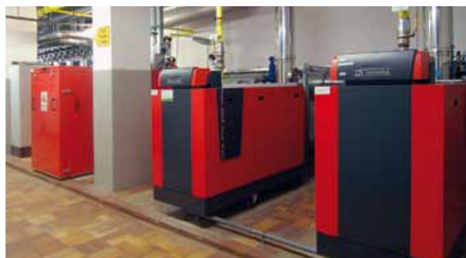
2 Remeha Gas ECO PRO (rechts) en de Remeha WKK (links)
