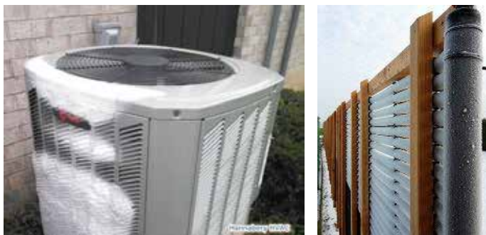
Figuur 38: Ijsafzetting op de verdampers van een lucht-warmtepomp (met ventilator) en een statische lucht-warmtewisselaar (zonder ventilator).
