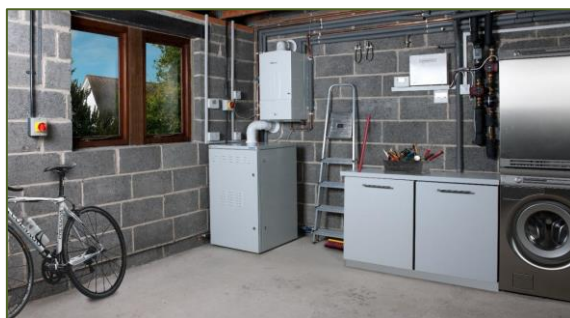
Figuur 14: Een huishoudelijke brandstofcel-WKK in de kelder.
